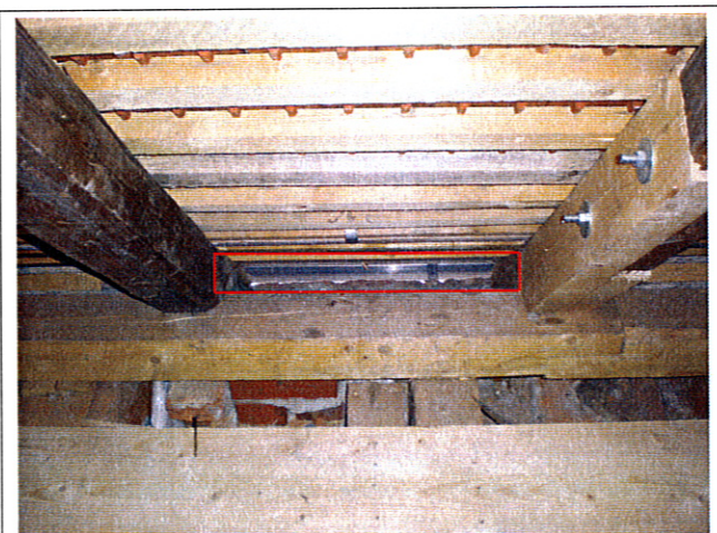
Bild 10: Kirchenschiff – Südseite, Fledermauseinschlüpfen sowie potentielle Brutplätze im Traufbereich zwischen zwei Sparren durch Weglassen der Vogelschutzgitter (rote Umrahmung, insgesamt 2 offene Sparrenfelder am südlichen Traufbereich)
