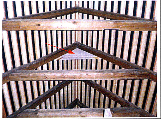
Bild 12: Kirchenschiff – Dachboden, Spaltenquartier (rote Pfeil, insgesamt 3 Stück auf Dachboden verteilt)
