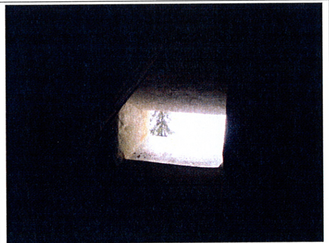
Bild 8: Kirchenschiff – Westgiebel, Fledermaus - Einflugöffnung zum Dachboden
